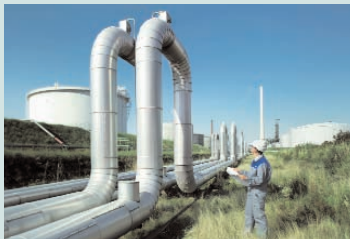
Voith Industrial Services: Ein Spezialist von Voith Industrial Services bei Arbeiten im Zuge von Rohrleitungsplanung und -bau in einer Raffinerie. Dienstleistungen in der Petrochemie gehören zu den anspruchsvollsten Tätigkeiten im Servicegeschäft des Unternehmens.
